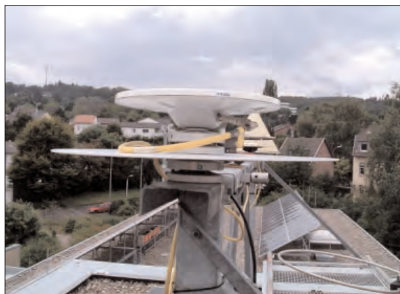
Abb. 15: Trimble-Zephyr-Geodetic-Antenne (TRM29659.00) mit zusätzlichem Dreifuß auf Grundplatte, hier ohne Radom (Foto: Galitzki)
