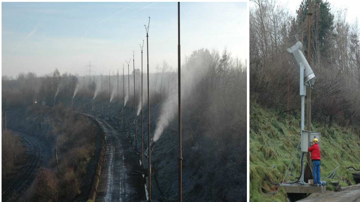
Abb. 5.3/2: Feinstnebelkanonen im Bereich des Kohlebunkers
