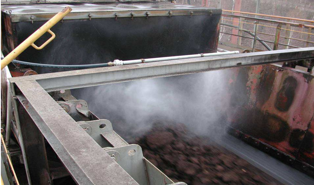
Abb. 5.3/3: Optimierung der Beregnerdüsen im Bereich der Kohleförderwege
