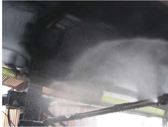
Abb. 5.3/10: Automatische Untergurtbedüsung im Bereich des Bandsammelpunktes sowie im Kohleförderweg
