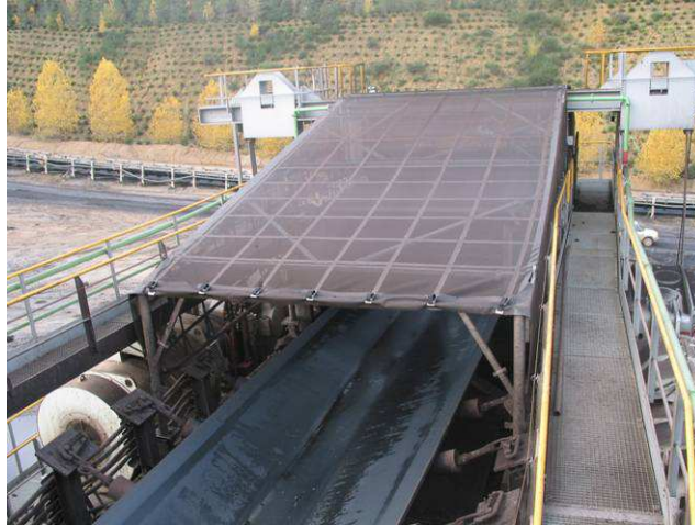
Abb. 5.3/9: Abdeckungen in den Übergabebereichen des Kohleförderweges
